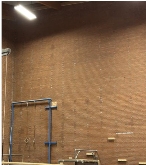
Afbeelding 3.1 Zoutaanslag ter plaatse van verankeringslijnen sporthal
